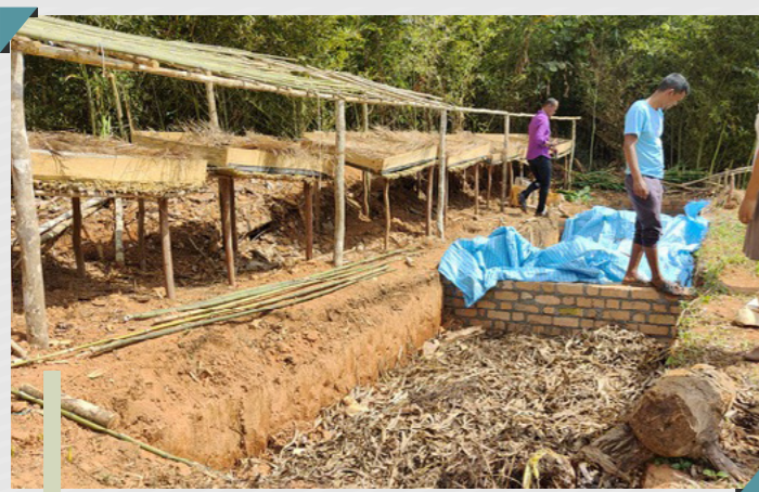
Caisse en bois surélevé à l'extérieur et protégé par une toiture en satrana Kesika nasiana tongony hampiakatra azy ambony ary voaaro amin'ny tafo satrana eny antokon-tany
